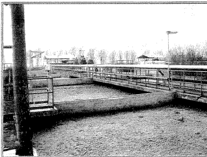
9. sz. kép: A szennyvíztisztító telep levegőztető medencéje
