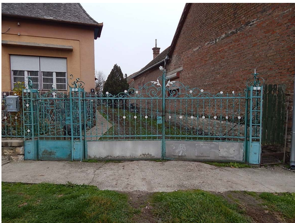
A 7-es számú épület kovácsoltvas kerítése, kapuja. Felületkezelése egységesebb színválasztással javításra szorul. A kerítés kapu megtartandó.
