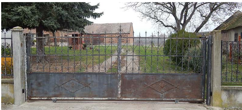
Kovácsoltvas kerítés kapuval, ugyanott. Felületkezelése javításra szorul A kerítés kapu megtartandó.
