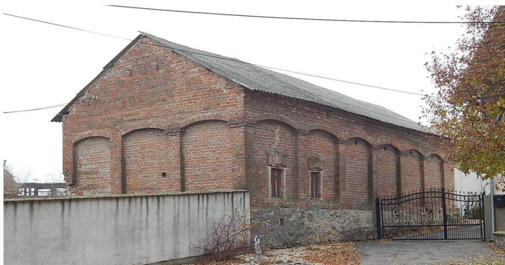
31. sz. pajtaépület homlokzat felújításról gondoskodni kell a csapadékvíz elvezetésével megtartandó.
