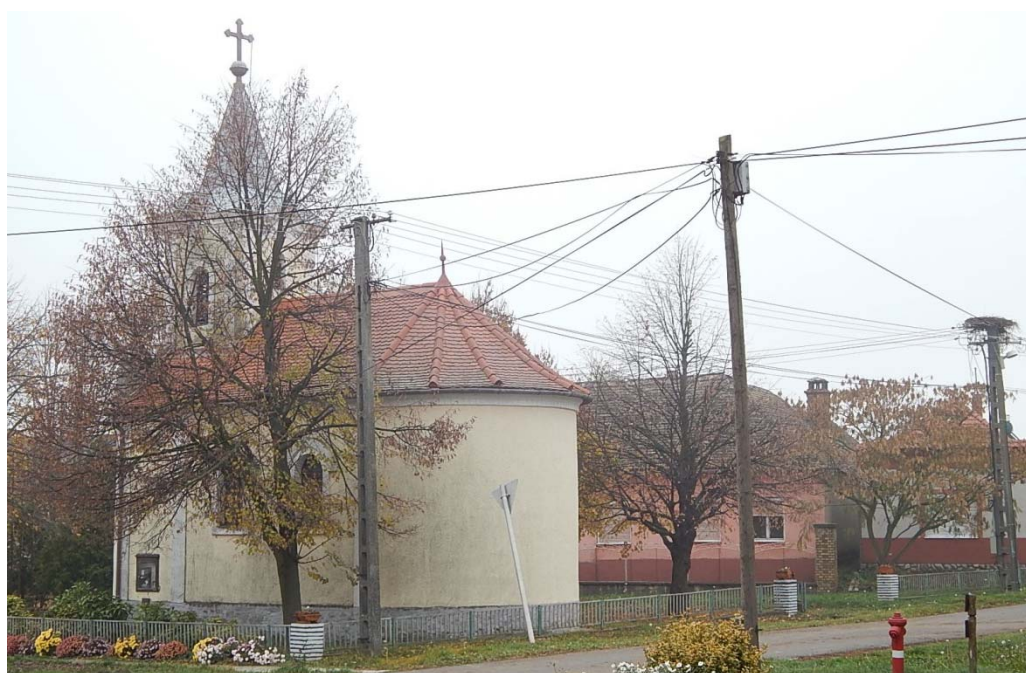
A homlokzatok, fedések és a csapadékvíz elvezetés felújításról gondoskodni kell
