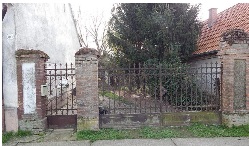
A Kossuth Lajos u. 32. szám kovácsoltvas kerítése kapukkal, téglapillérekkel felújítandó településképi történeti érték.
