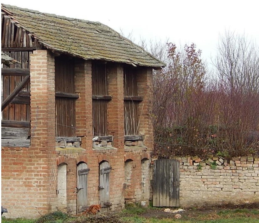
és látszó tégl architektúrárs melléképülettel; településképi történeti érték. Homlokzatának fagykárosult részei felújításról gondoskodni kell és a csapadékvíz elvezetés megoldandó.
