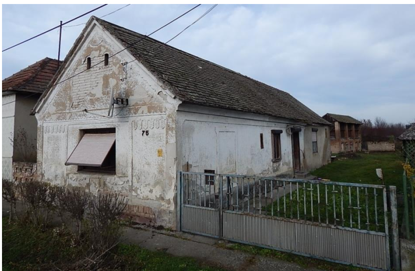
A Kossuth Lajos u. 75. szám alatti népi lakóház vakolathímes oromzattal. A főhomlokzat eredeti nyílásrendszerét régi fotók, falkutatás, vagy analógiák alapján helyre kell állítani. A vakolathím helyreállítandó.
