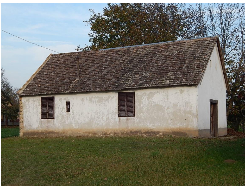
Girótfá présház-pince, az épület lábazatánál a csapadékvíz elvezetést ki kell építeni.
