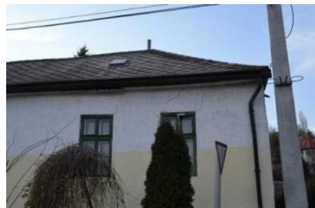
46. repedések a homlokzaton
